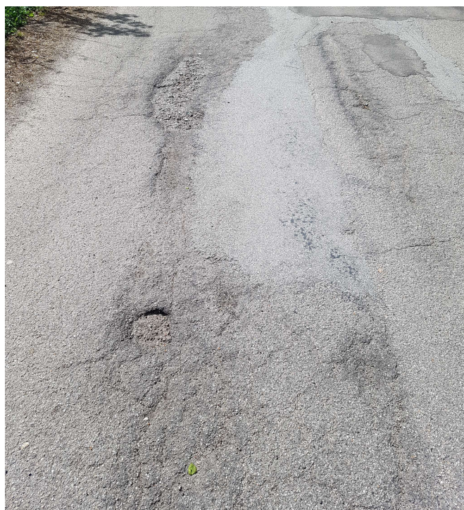
Figur 2.3 - Område hvor der lokalt bør udføres en partiel udskiftning af slidlaget.
