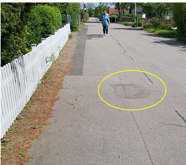
Figur 2.5 - Område på stamvejen hvor der muligvis kan være et problem med underliggende utætte kloak- eller vandrør
